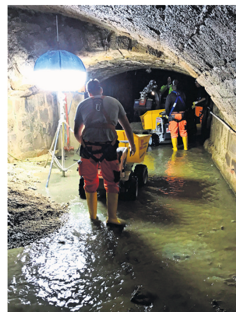
Tonnenweise Schutt und Steine musste die Stadt nach dem Starkregen aus Kanälen befördern. Foto: Stadt Esslingen
